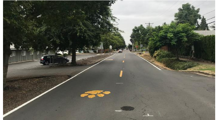
El camino existente carece de aceras continuas a la preparatoria Newberg High School. La carretera carece de instalaciones de aguas pluviales y el pavimento necesita ser reemplazado.
